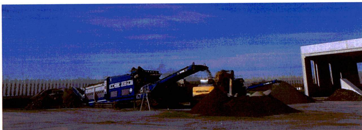
Figura 5-5 – Impianto di vagliatura
