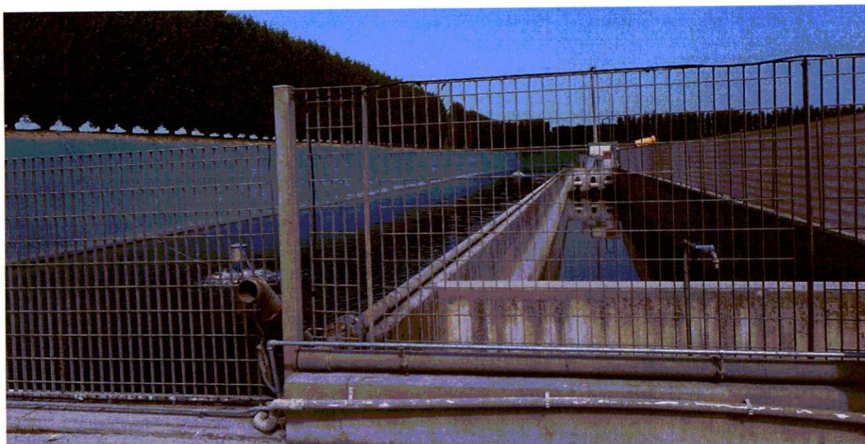
Figura 10-5 - Impianto di raccolta acque meteoriche
