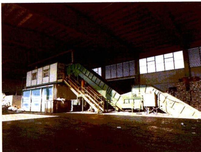
Figura 5-2 - impianto di recupero carta e plastica
