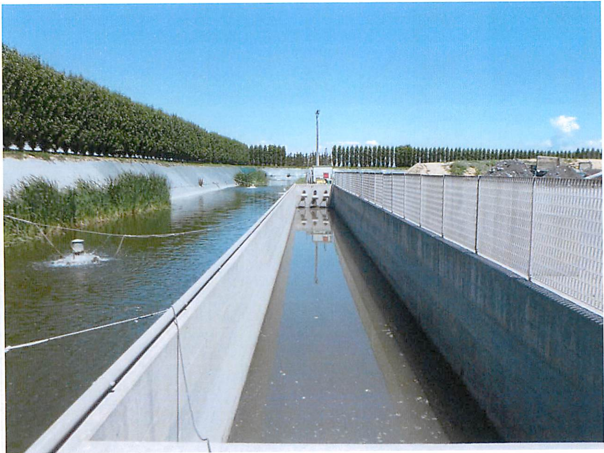
Figura 4 - Impianto di raccolta acque meteoriche
