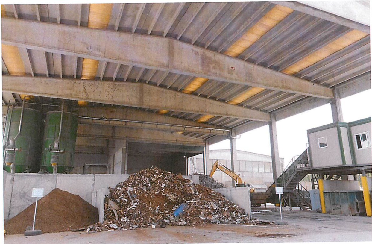
Figure 1 – Interno capannone AS5 e cernita manuale -
