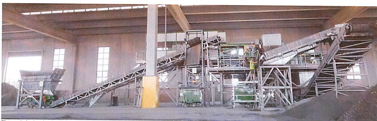
Figura 5-4 - Impianto di demetallizzazione
