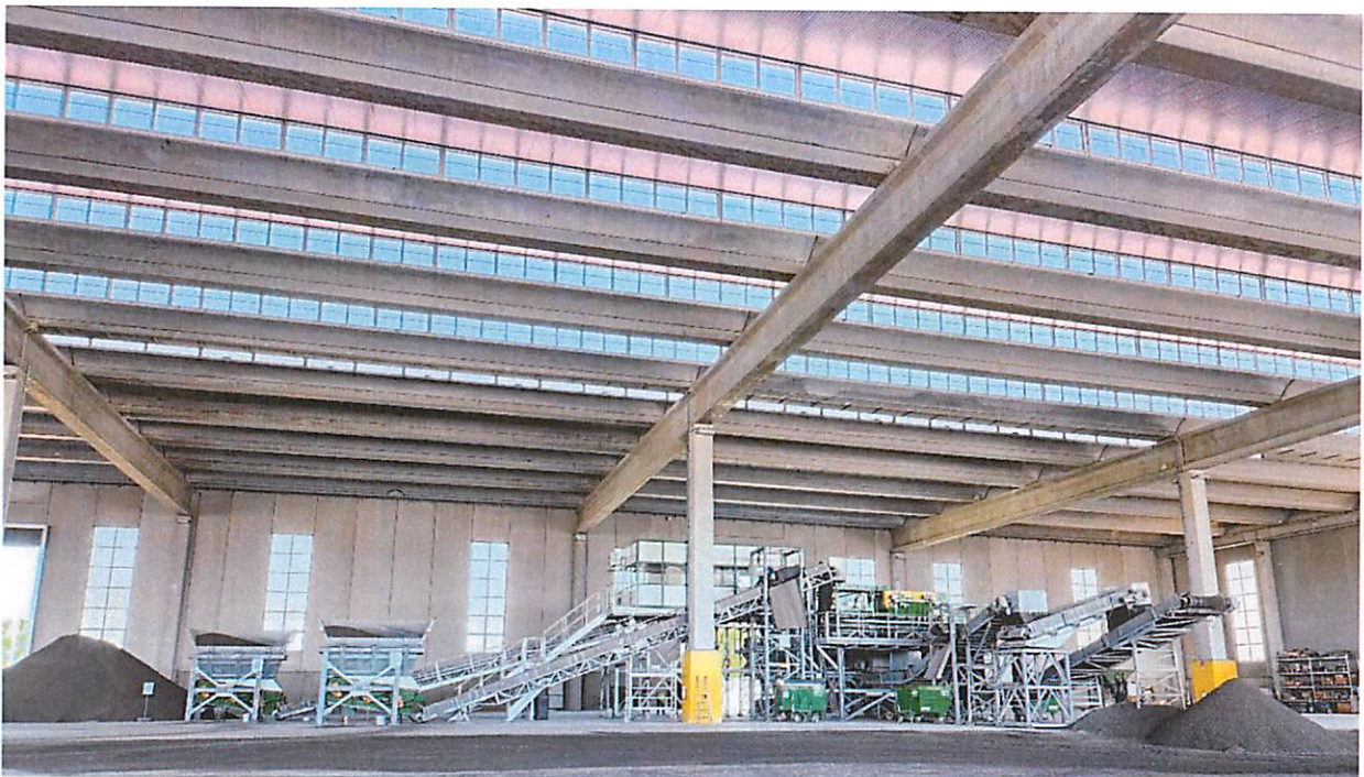
Figura 12 - Impianto di demetallizzazione
