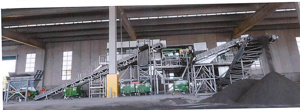
Figura 5-4 - Impianto di demetallizzazione
