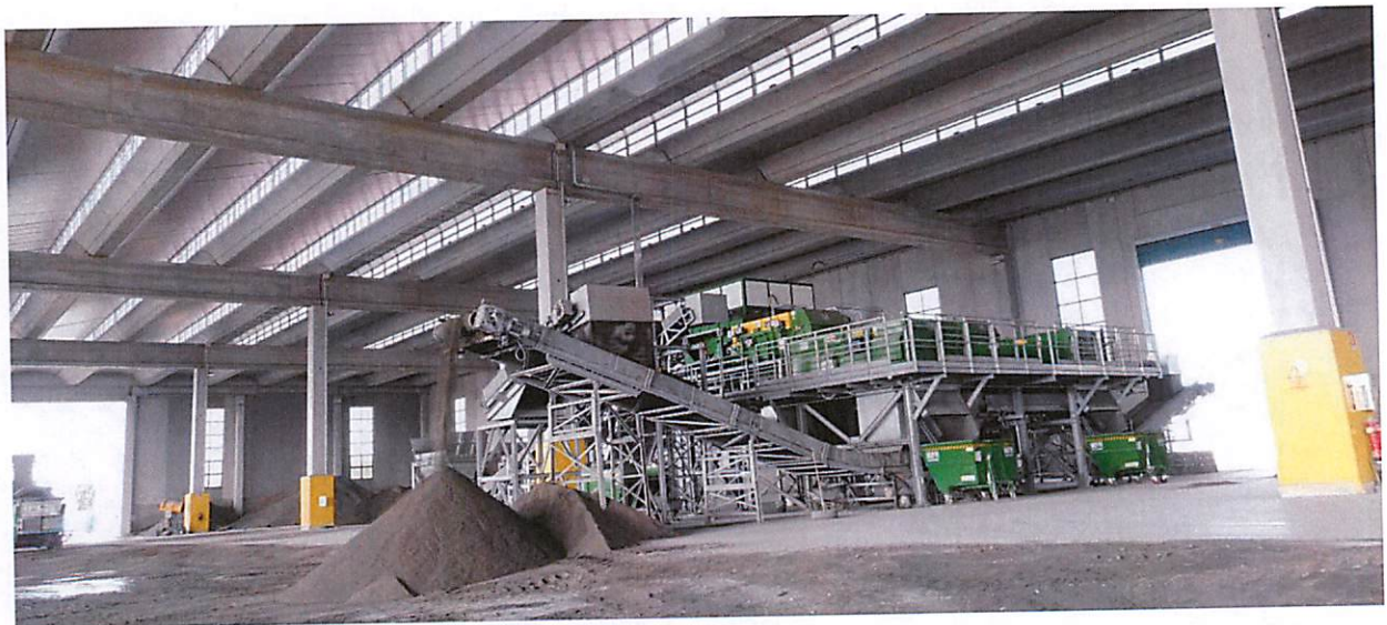
Figura 2 - Impianto di demetallizzazione
