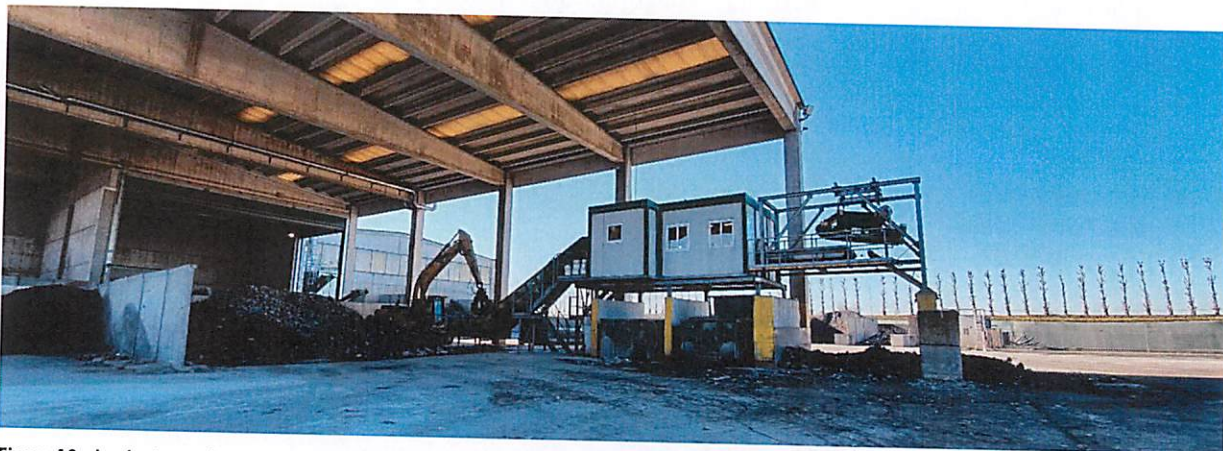
Figura 10 - Impianto cernita manuale
