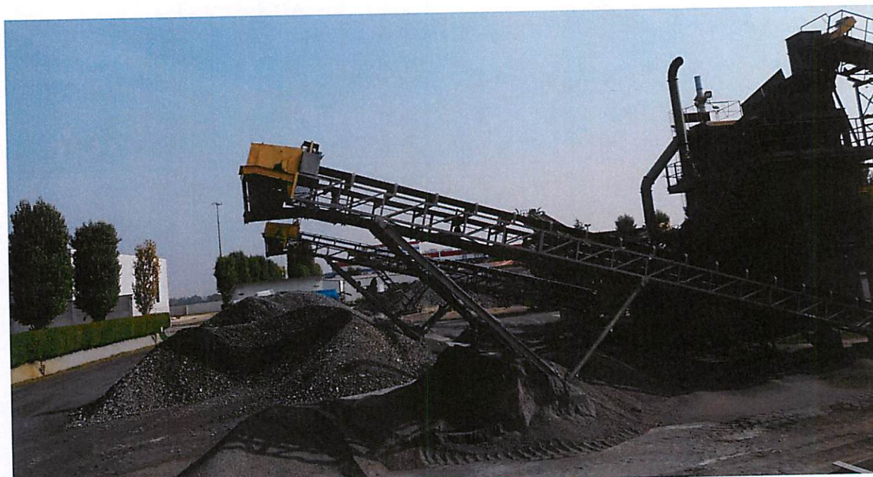
Figura 5-5 - Impianto di trattamento
