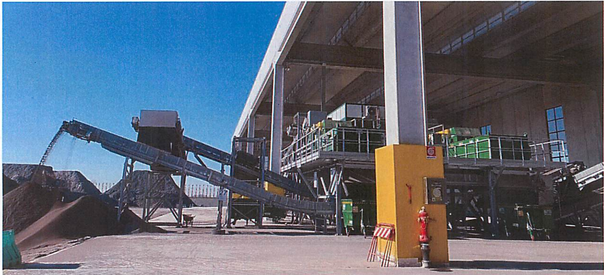
Figura 10-3 - Nuovo impianto demetallizzazione
