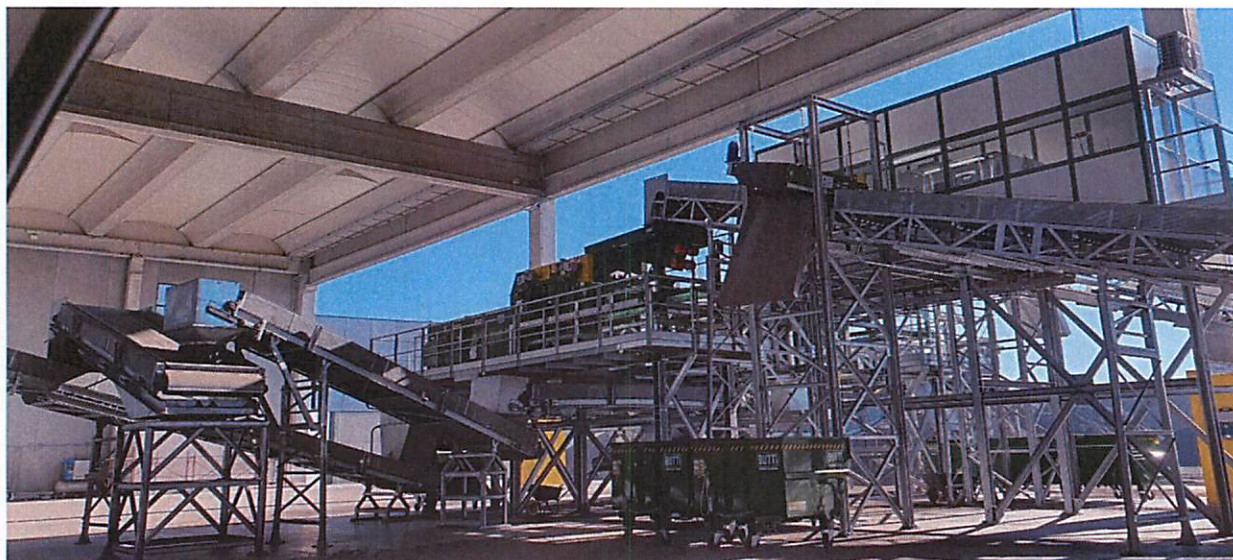
Figura 5-4 - Nuovo impianto di demetallizzazione
