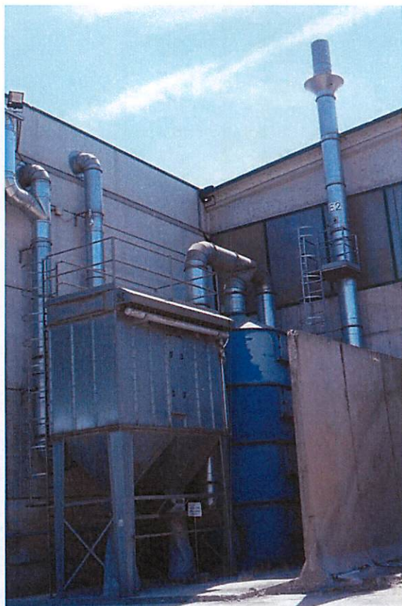
Figura 10-7 - Impianto emissioni aeriformi E2
