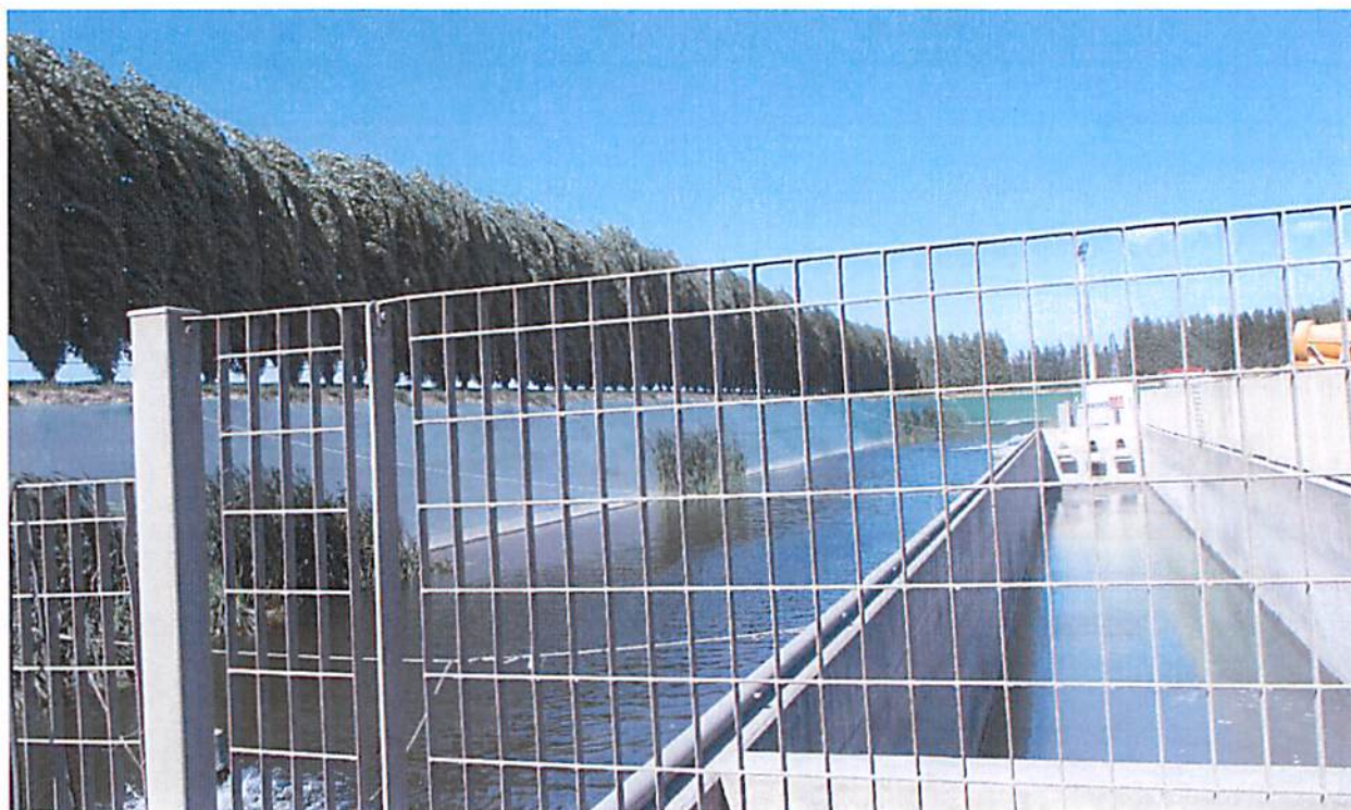
Figura 4 - Impianto di raccolta acque meteoriche
