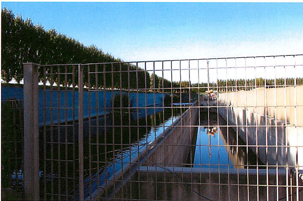
Figura 4 - Impianto di raccolta acque meteoriche – Settembre 2016
