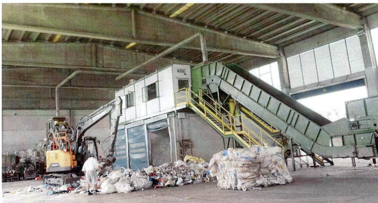
Figura 5-2 – Impianto di recupero carta e plastica
