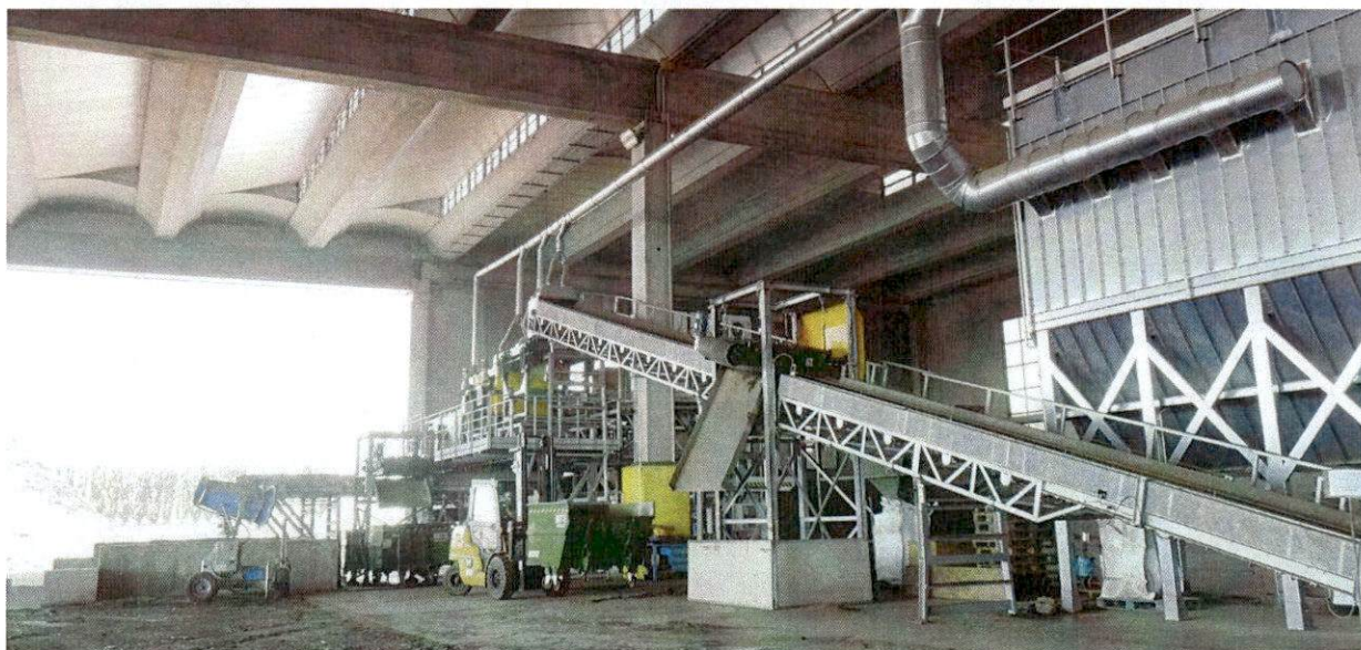
Figura 5-3 - Impianto di demetallizzazione
