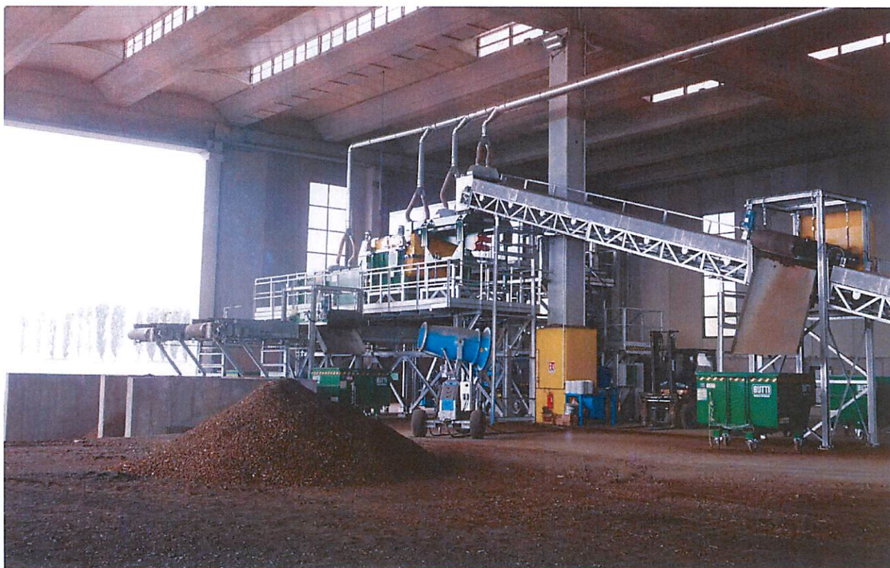
Figura 2-1 - Nuova linea di demetallizzazione
