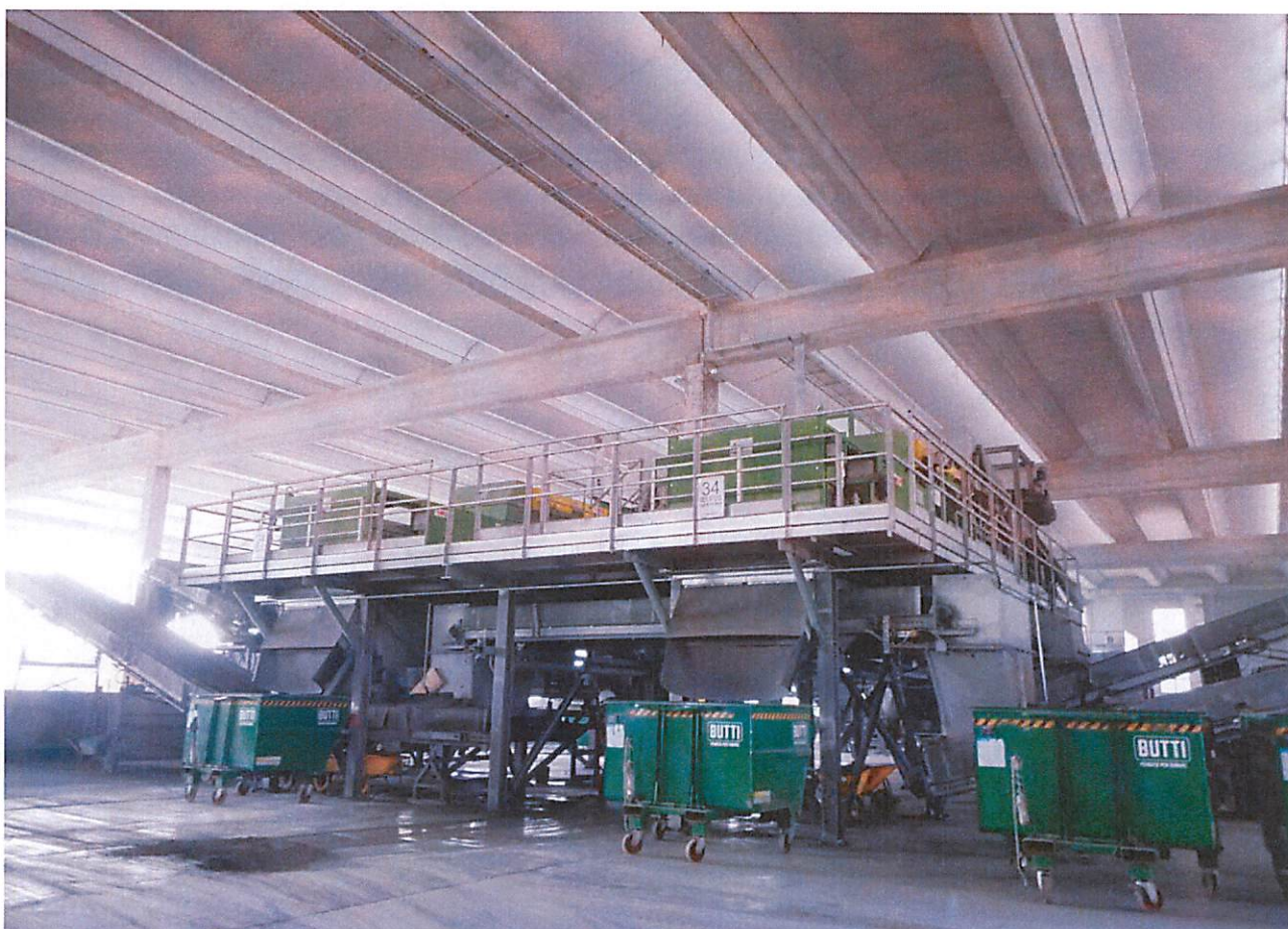
Figura 5-3 - Impianto di demetallizzazione
