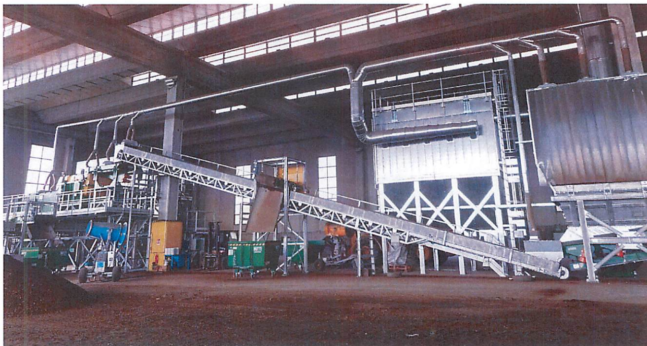
Figura 10-5 – Nuovo impianto di demetallizzazione
