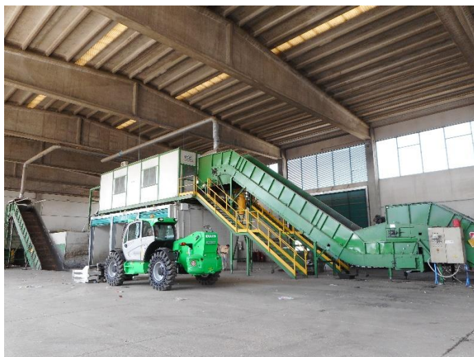
Figura 5-2 - impianto di recupero carta e plastica
